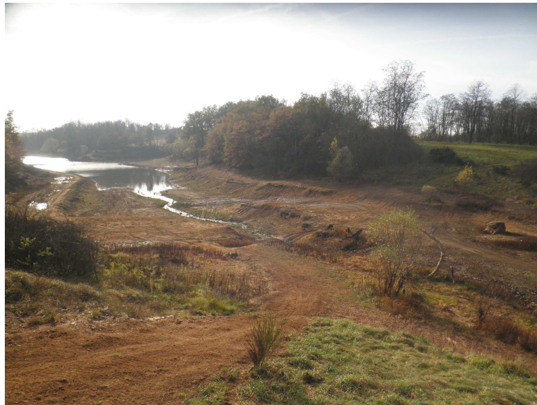
Figure 3 : Partie amont de la retenue où ont été faits les travaux de terrassement, au niveau où le ruisseau de Vert rejoint et alimente le plan d'eau
