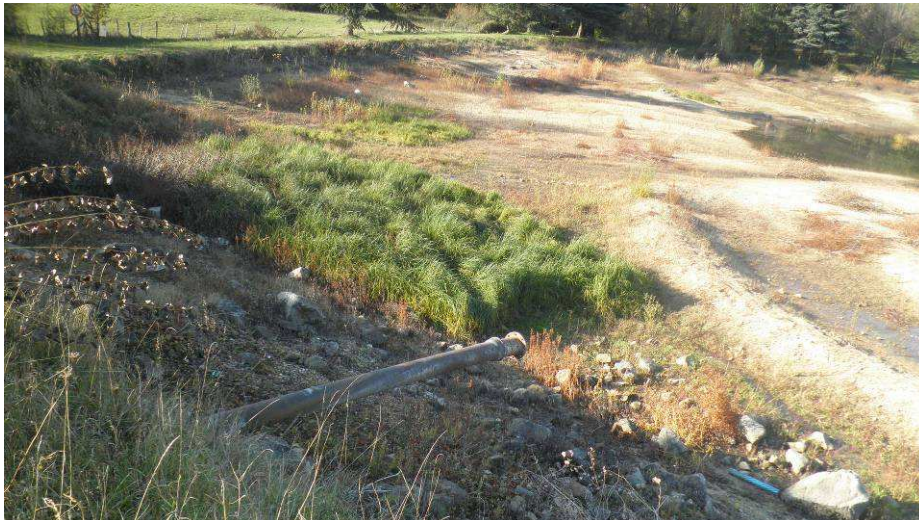
Figure 8 : Canalisation AEP débouchant au dessus du plan d'eau - photo du 15/11/11
