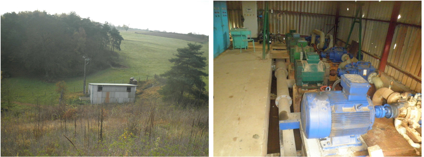
Figure 2 : Local des pompes sous la retenue (à gauche) et pompes (à droite)
